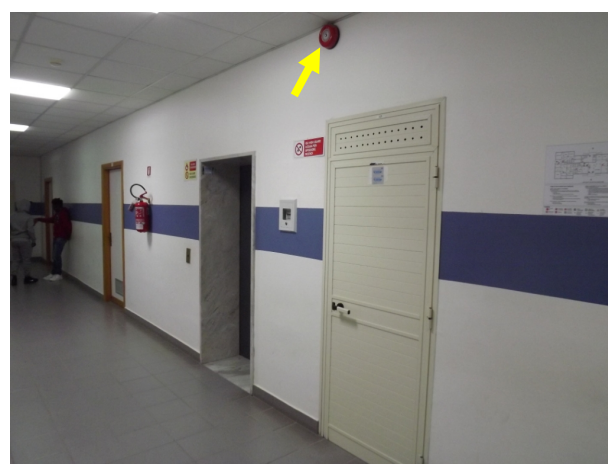
Foto 4 - Campanella di allarme corridoio pia-
