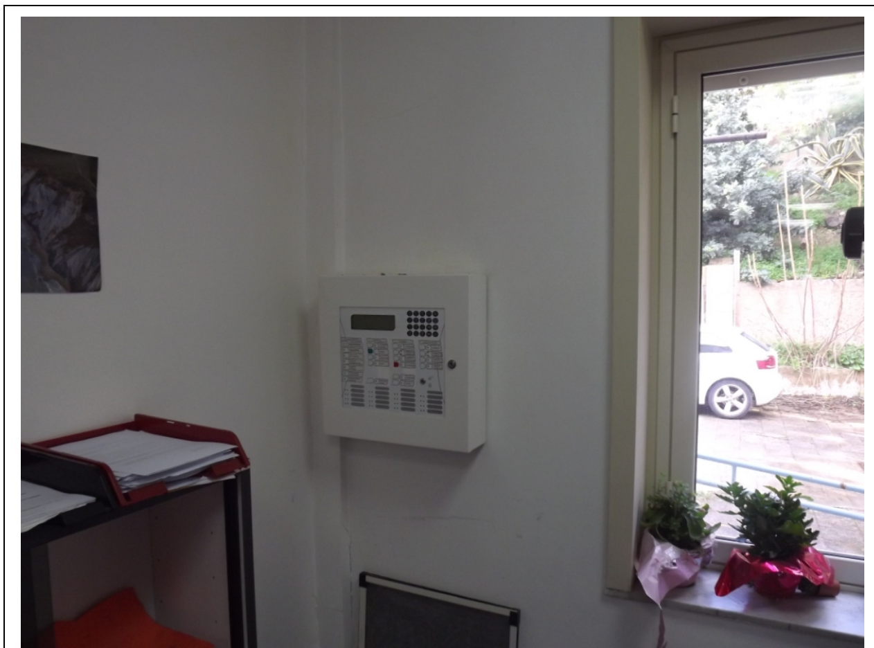
Foto 1 - Centrale di allarme incendi esistente
