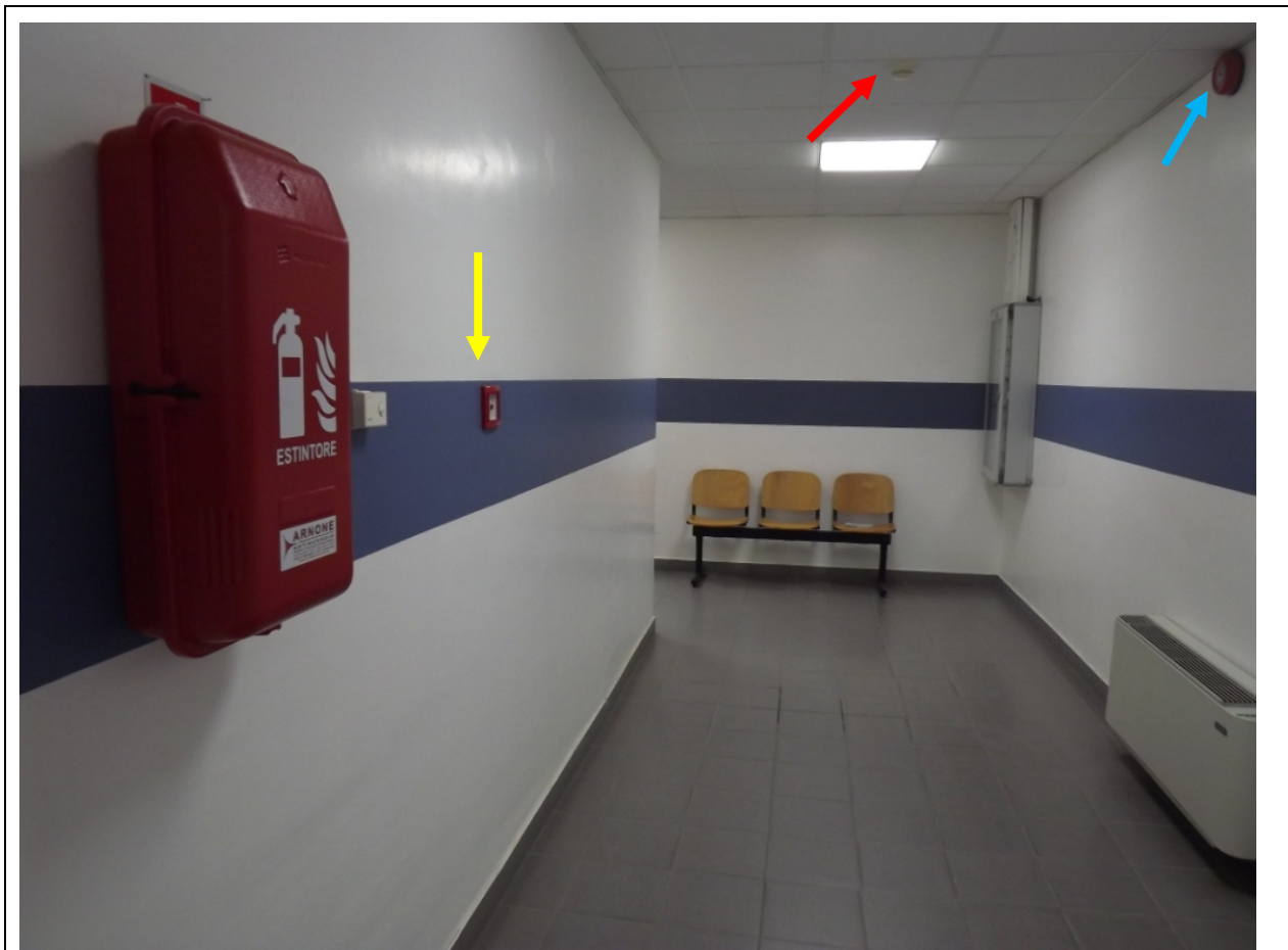
Foto 2 - Schema di posizionamento estintore - Pulsante allarme incendi (freccia in giallo) - Rilevatore di fumo (freccia in rosso) - Campanella di allarme (freccia in ciano)
