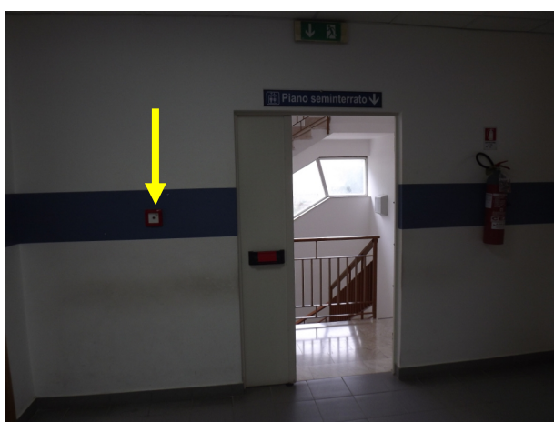
Foto 3 - Rilevatore di fumo (accesso scala)
