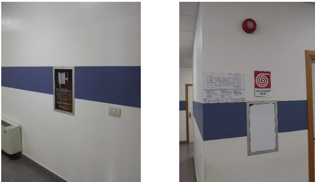
Figura 1 - Idranti UNI45 esistenti
