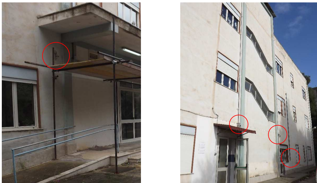
Figura 3–Tubazioni di alimentazione degli idranti UNI45 predisposte per l’allaccio all’esterno (prospetto Ovest e Sud)
