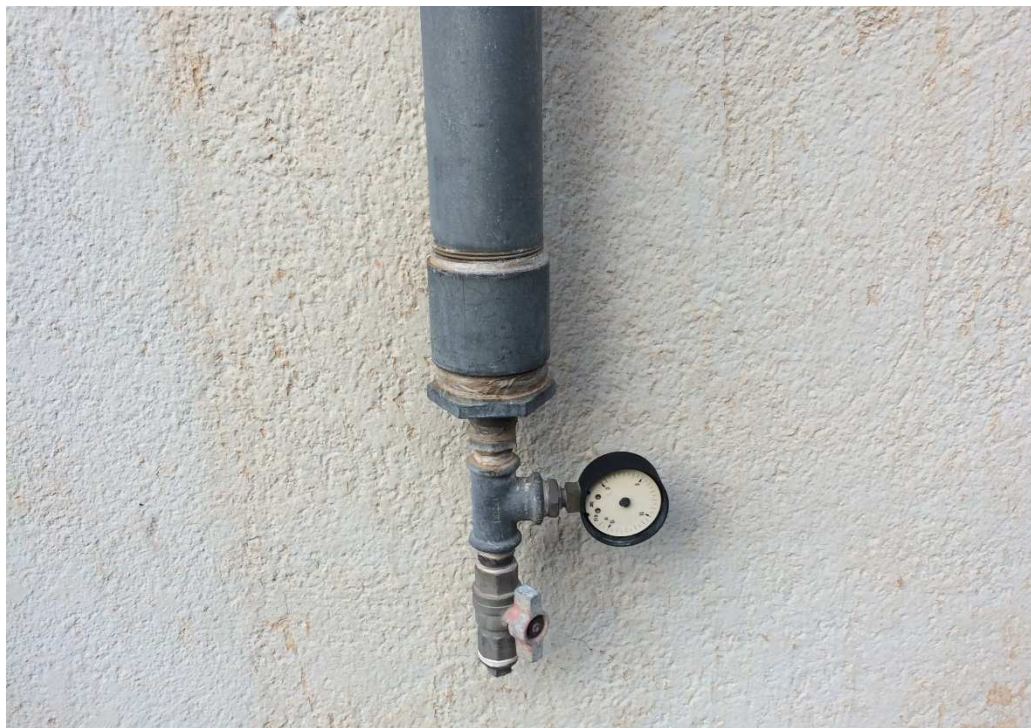
Figura 2–Dettaglio tubazione con arresto e manometro di prova
