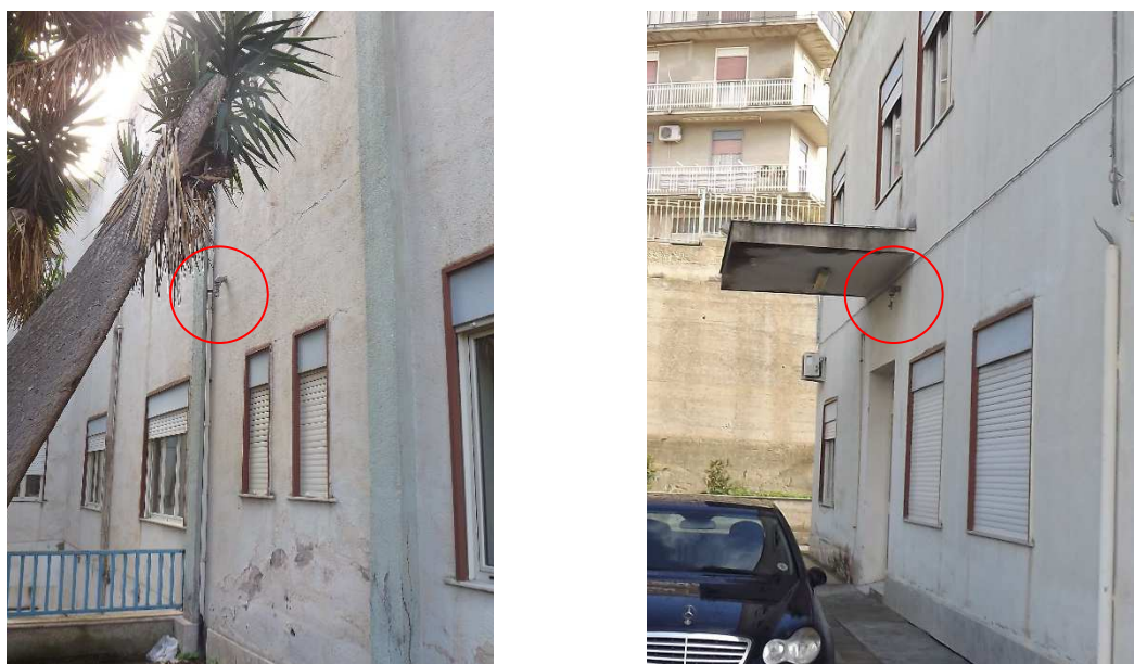
Figura 4–Tubazioni di alimentazione degli idranti UNI45 predisposte per l’allaccio all’esterno (prospetto Est e Nord)
