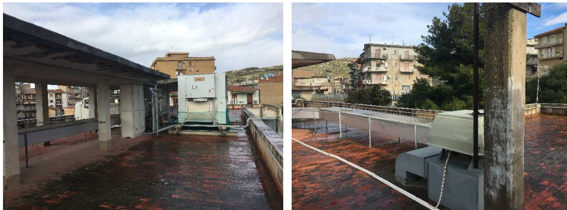
Figura 13 – Macchine e canali in copertura
