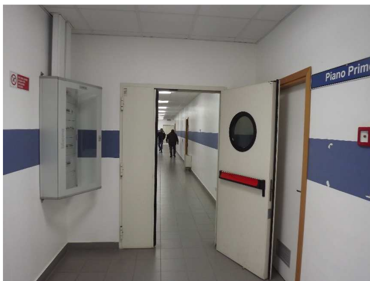
Figura 6 – Porta REI120 di separazione dei corridoi al piano primo
