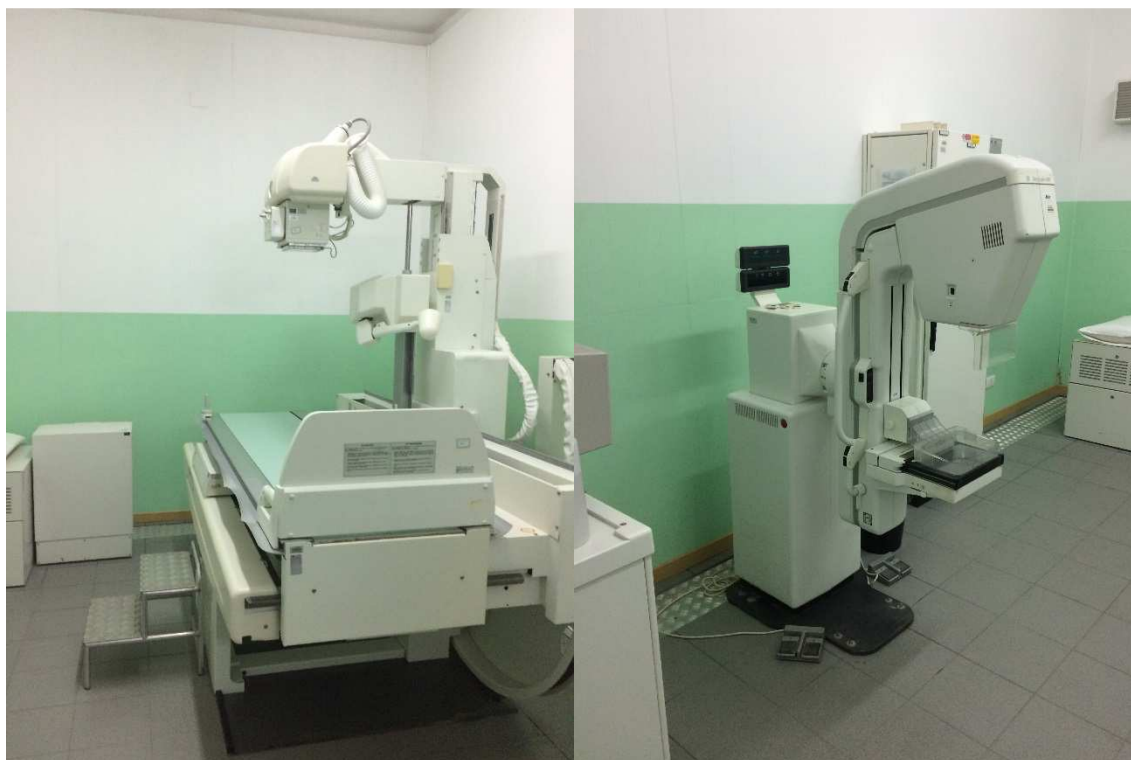
Figura 1–Apparecchiature all'interno della Sala Rx al piano seminterrato
