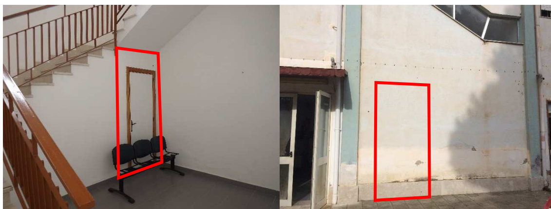
Figura 12 – Zona al piano seminterrato in cui si prevede di realizzare l'uscita di sicurezza
